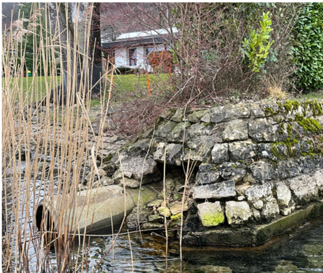
Schaden an der Seemauer in der Thomasgaslänti.
