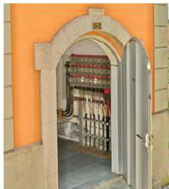
Links: Neuer Trafo Sonnenflueh
